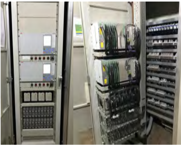
Ilustración: Frente interior del tablero de protecciones
