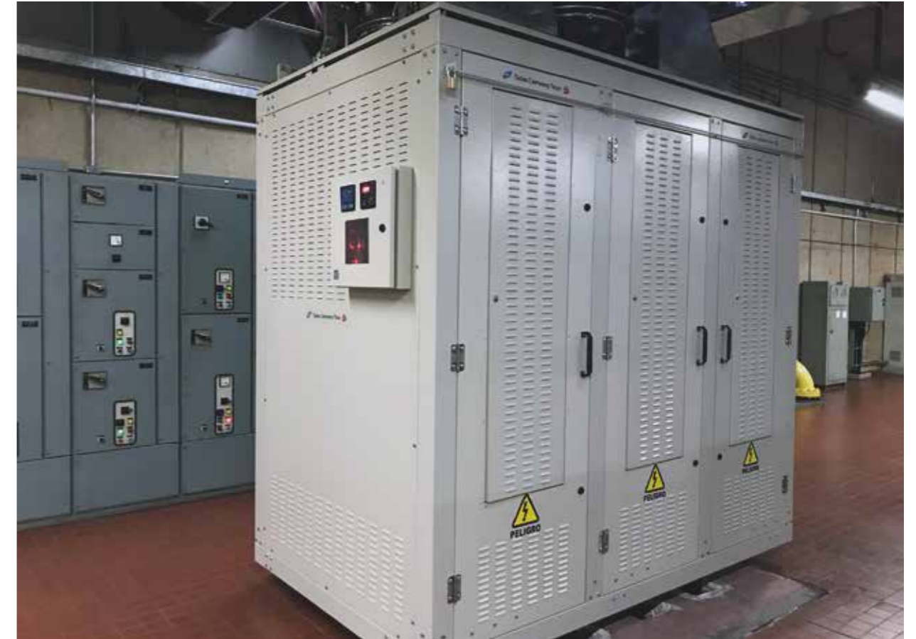
Transformadores de excitación de los generadores
